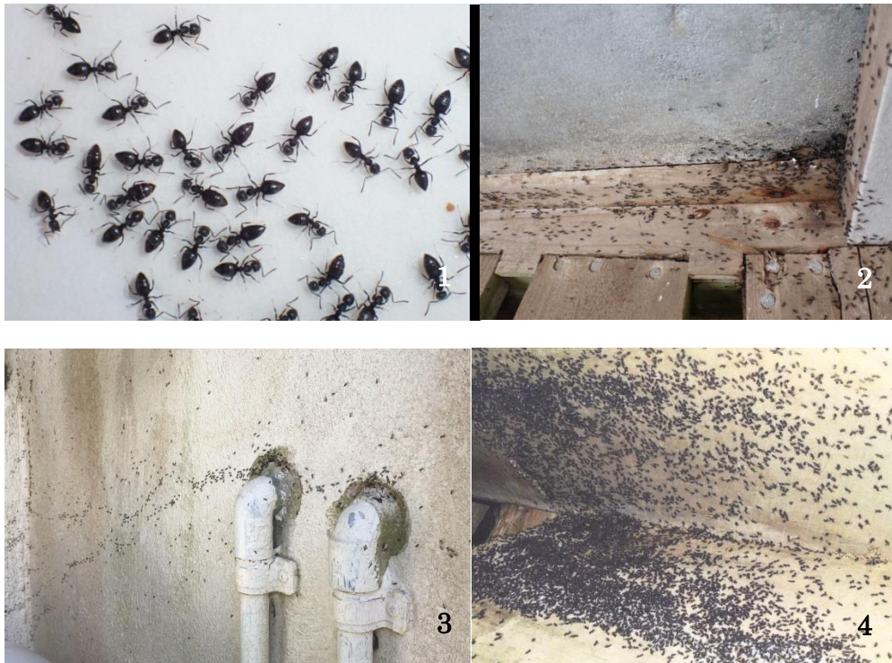
図 7.2.5. アシジロヒラフシアリ Technomyrmex brunneus . 1, 働きアリ. 2, 縁台に行列を作るアシジロヒラフシアリ. 3, 外壁に複数の行列を作るアシジロヒラフシアリ. 4, 家屋付近のアシジロヒラフシアリの巣. 物資の下や間, 壁の隙間, 空調や電気設備等の機器の中等いたる所にサナギや幼虫を運び込み巣とする.
